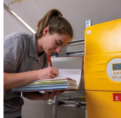
^ L'operatrice di edifici e infrastrutture controlla regolarmente i dati tecnici degli impianti di riscaldamento e di ventilazione e li annota nel suo dossier.
